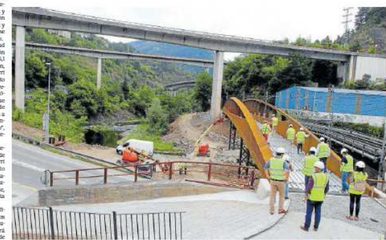
Vista de la nueva pasarela de 81 metros instalada en Maltzaga para superar el río Deba y la carretera GI-627.
